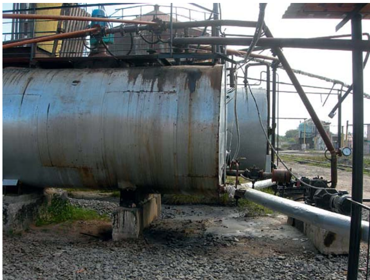
Фото 1. Общий вид установки производства ПБВ в ОАО «ДСТ №2, г. Гомель»
